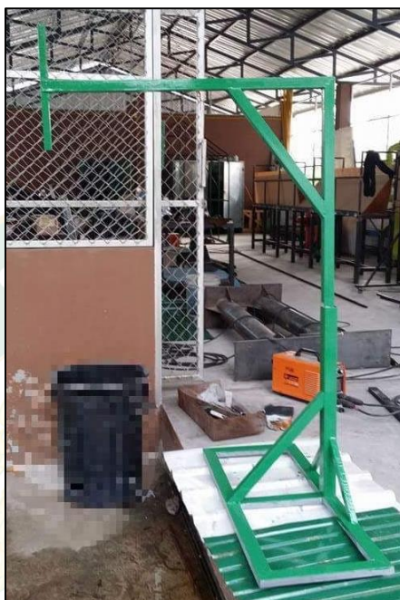
ภาพที่ 58 เสาตั้งคอมสปอร์ตไลท์
