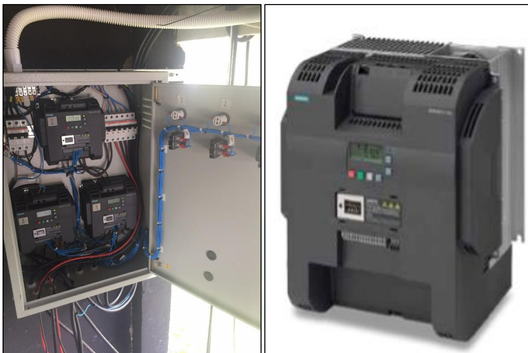
รูปที่ 18 Hybrid Inverter ในการติดตั้งจริง
