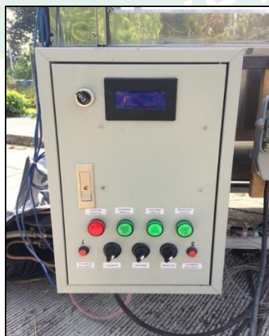
ภาพที่ 29 ตู้ควบคุม
