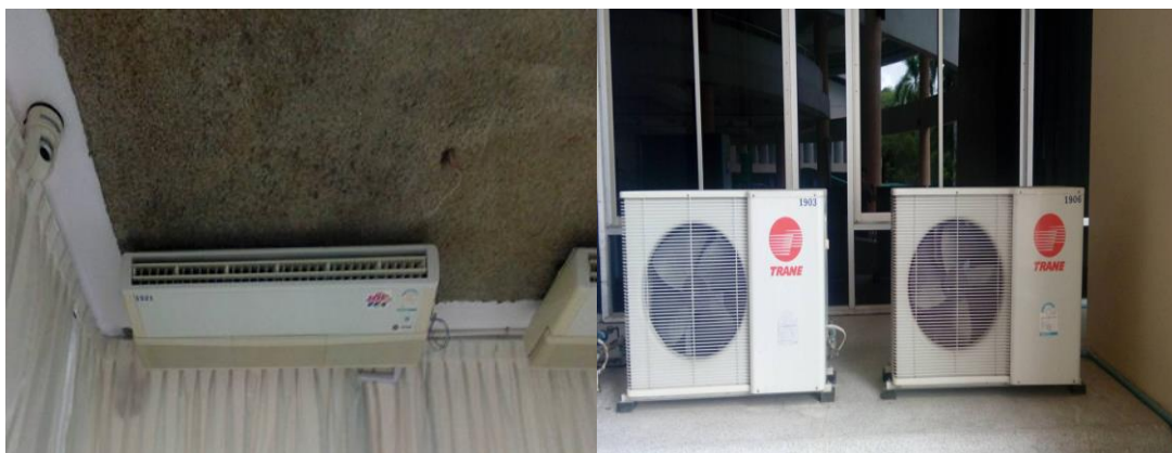
ภาพที่ 76 ลักษณะเครื่องปรับอากาศแบบแยกส่วน (Split Type) ของอาคาร 70 ปี แม่โจ้
