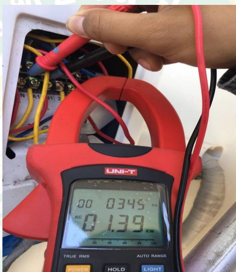
ภาพที่ 50 การตรวจวัดกำลังไฟฟ้าเครื่องอัดไอ
