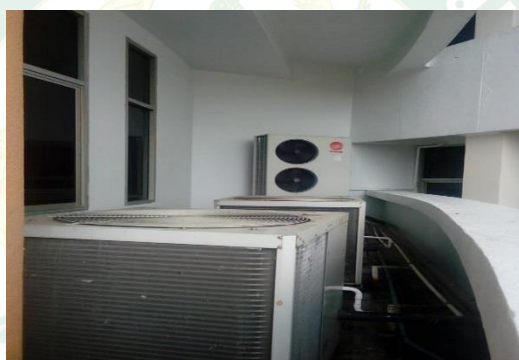
(ก) ลักษณะการติดตั้ง Condensing Unit ห้อง 301/1
