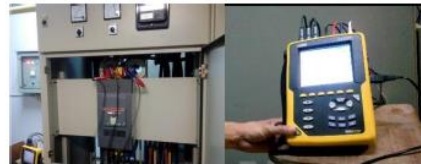
ภาพ 5 การวัดพลังงานไฟฟ้าจากตู้ MDB ด้วย Energy Meter
