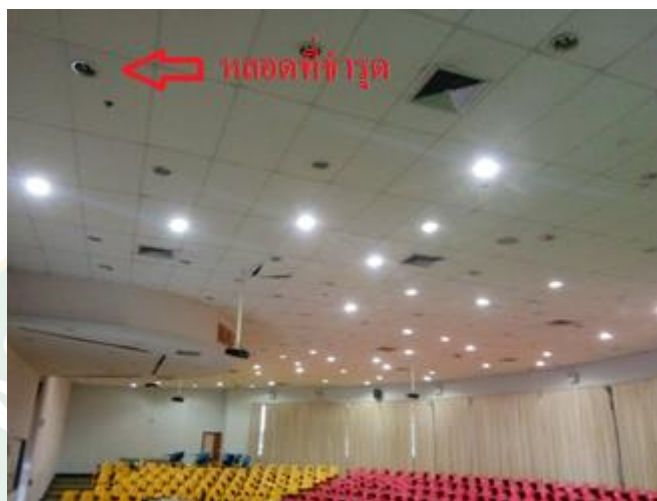
ภาพที่ 71 ลักษณะการติดตั้งหลอดไฟ ห้อง 301
