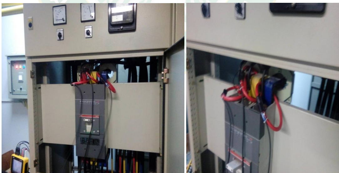
ภาพที่ 53 การตรวจวัดด้านไฟฟ้าของอาคาร 70 ปี แมจโจ ที่ ตู้ Main Distribution Board (MDB)
