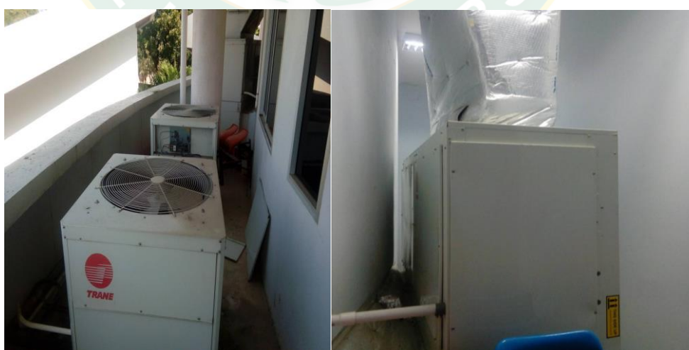
(ข) ลักษณะเครื่องปรับอากาศแบบชุดหรือแพ็คเกจ (Package) ของอาคาร 70 ปี แมงไฉ้
