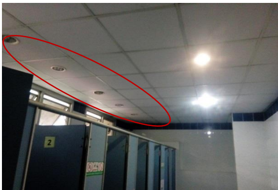
ภาพที่ 74 ลักษณะบริเวณห้องน้ำที่มีหลอดไฟชำรุด
