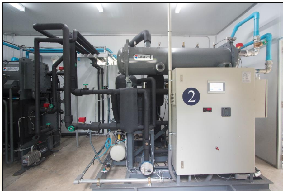
ภาพที่ 21 ระบบผลิตไฟฟ้าด้วยวัฏจักรแรงดันอินทรีย์
