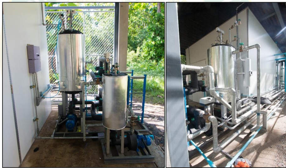
ภาพที่ 30 ถังเก็บน้ำร้อน ถังเก็บน้ำเย็น และระบบท่อต่าง ๆ
