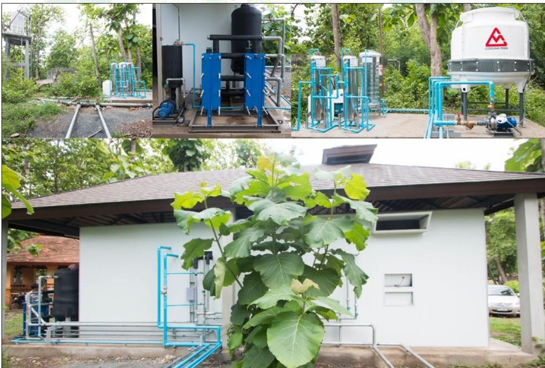
ภาพที่ 32 ลักษณะระบบจ่ายน้ำพุร้อน ระบบจ่ายน้ำสะอาด และระบบระบายความร้อนเมื่อแล้วเสร็จ
