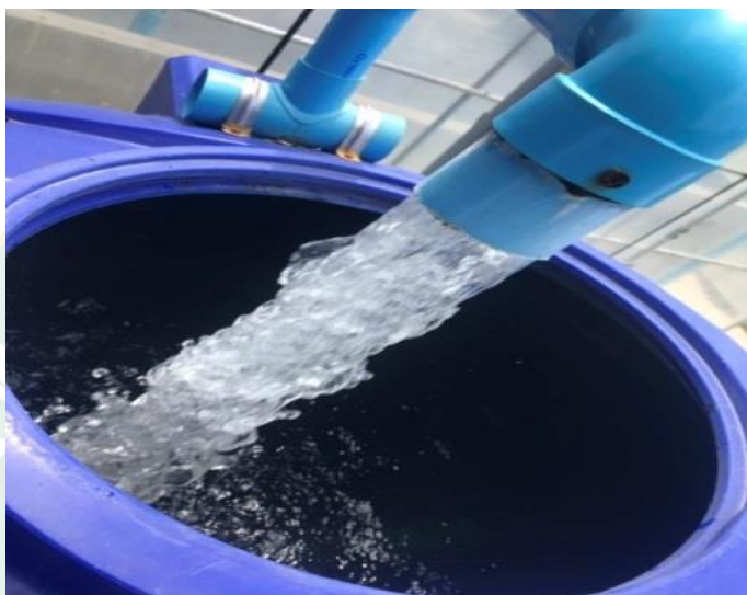
ภาพที่ 5 ถังกรองตะกอน (Mechanical filtration tank)
