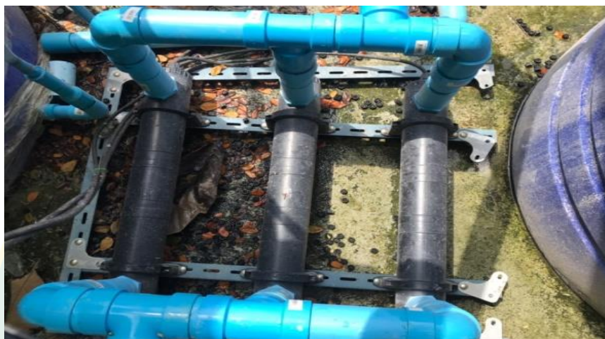
ภาพที่ 8 ระบบฆ่าเชื้อ (Ultraviolet filter)
