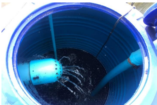
ภาพที่ 7 ถังกรองชีวภาพถังที่ 2 (Fixed-bed bioreactor tank)
