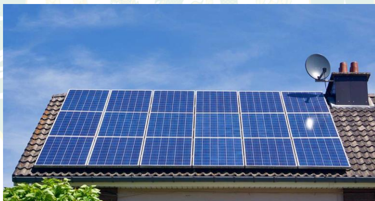
ภาพที่ 5 Solar PV roof top
