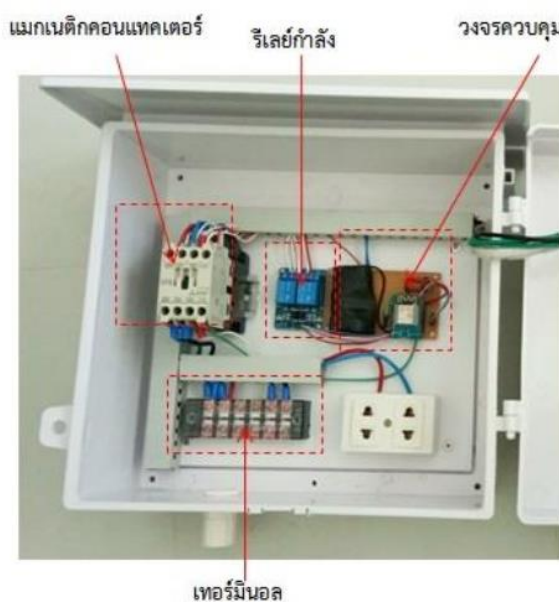
ภาพที่ 25 ระบบควบคุมเครื่องเติมอากาศแบบอัตโนมัติในบ่อเลี้ยงปลา ที่มา: (ศิริวรรณ ทำนุ, 2561)
