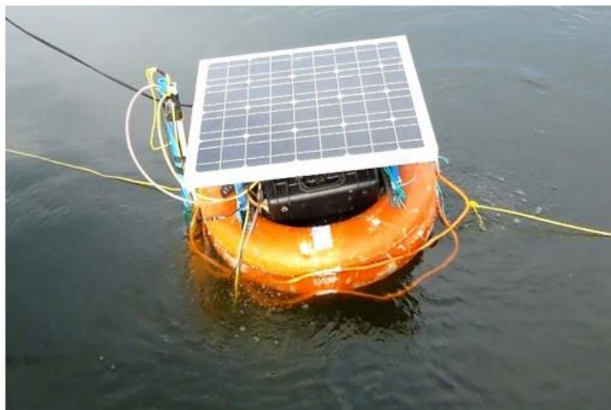
ภาพที่ 24 ระบบตรวจสอบคุณภาพน้ำ
