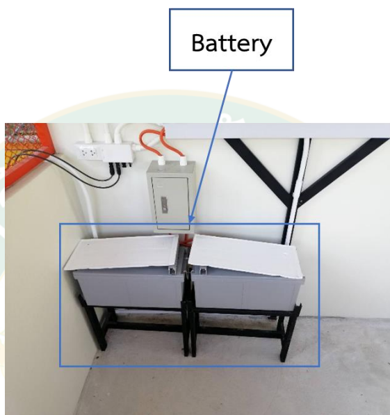
ภาพที่ 55 แบตเตอรี่สำรองพลังงานไฟฟ้า
